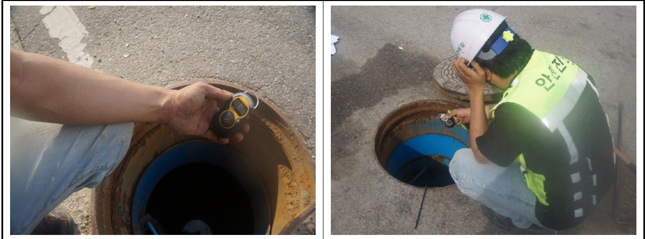
[밸브실 산소 및 유해가스 농도 측정]
